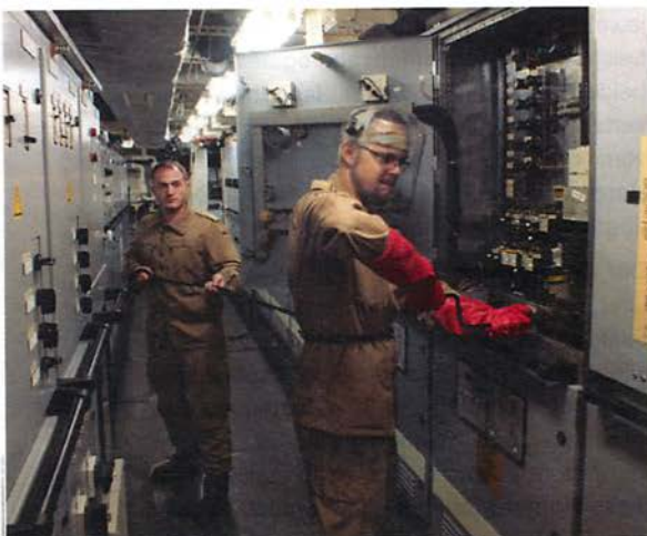
Soldaten bei Arbeiten im E-Schalttafelraum
